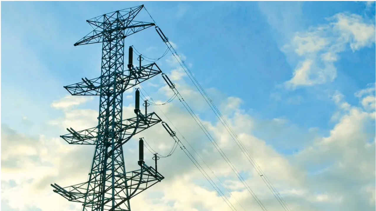
Torre de electricidadlarazon
