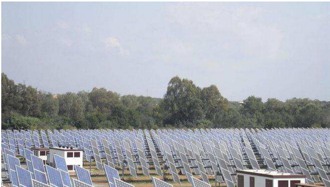
Detalles de paneles instalados en una planta fotovoltaica de Sevilla. / M. G.
