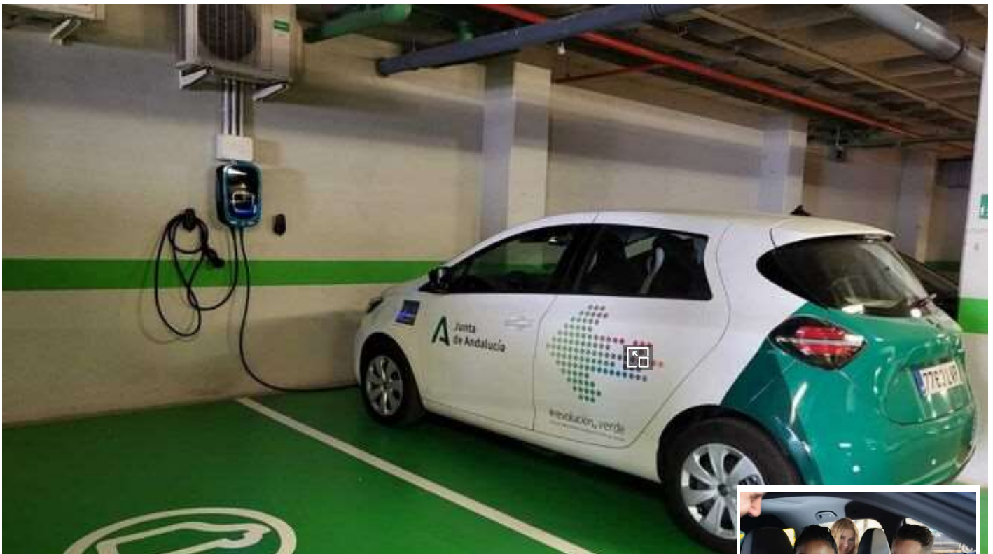
Punto de recarga de un vehículo eléctrico
