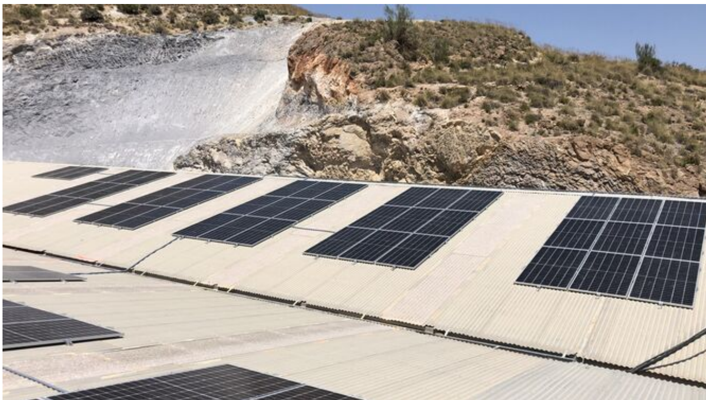
Placas fotovoltaicas en Natural Stone Tino en Macael.
