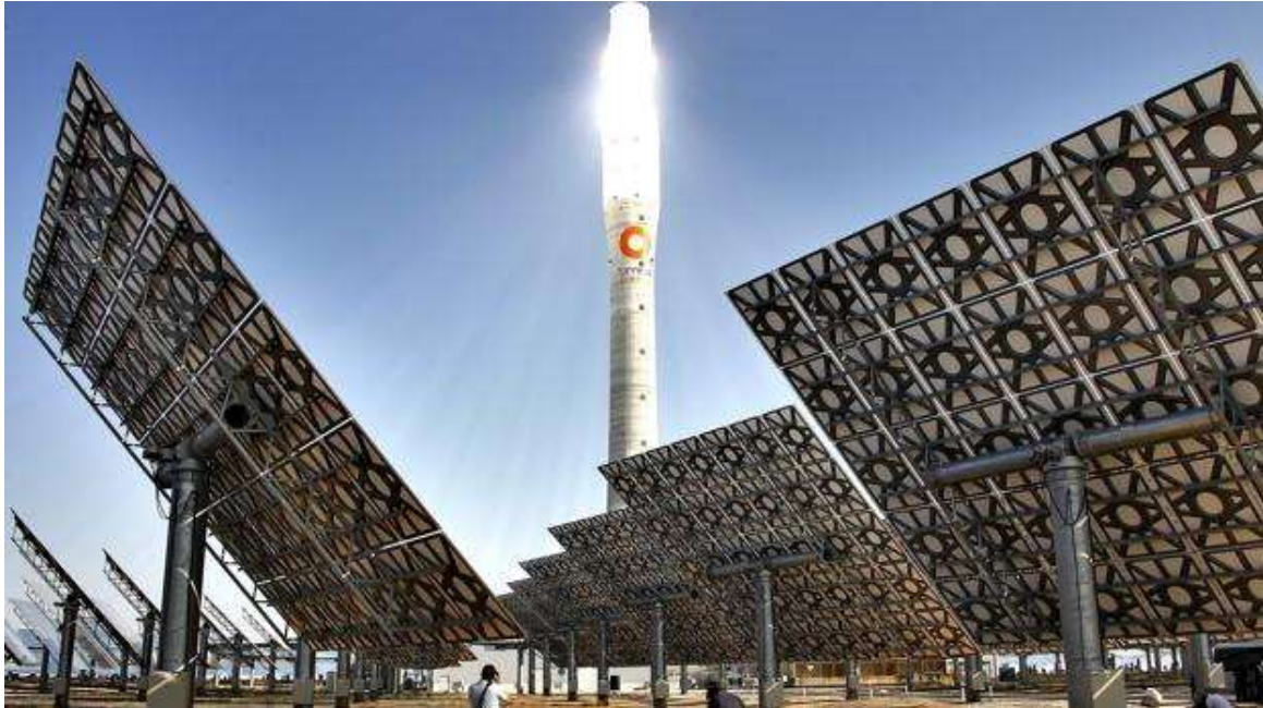
Planta termosolar de Fuentes de Andalucía - J.M.SERRANO
