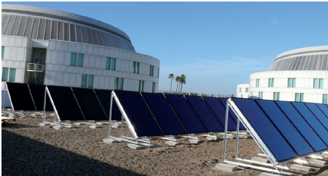
Figura 8: Ejemplo de Instalación solar con captadores solares planos
