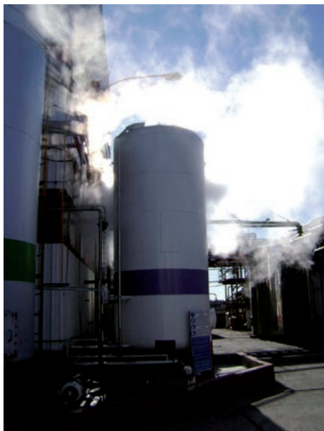
Fig. 49: Depósito de mezcla de condensados y agua tratada para la de alimentación de calderas.
