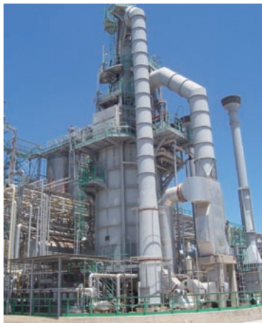
Vista de horno de proceso de una industria petroquímica
