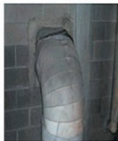
a) Aislamiento de una tubería dañado parcialmente.
