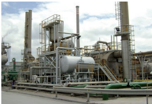
Vista de caldera de vapor de una fundición
