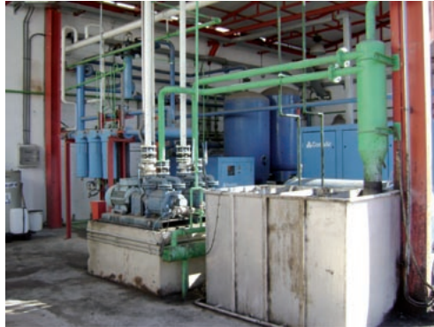
Fig. 38: Detalle de instalación de aire comprimido
