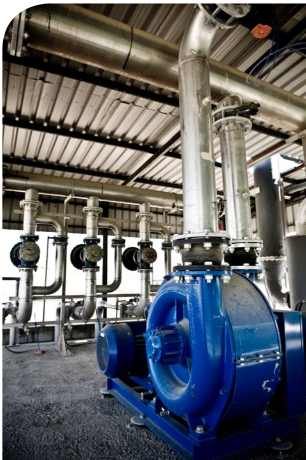
Aprovechamiento energético de gas de vertedero (Alcalá del Río)
