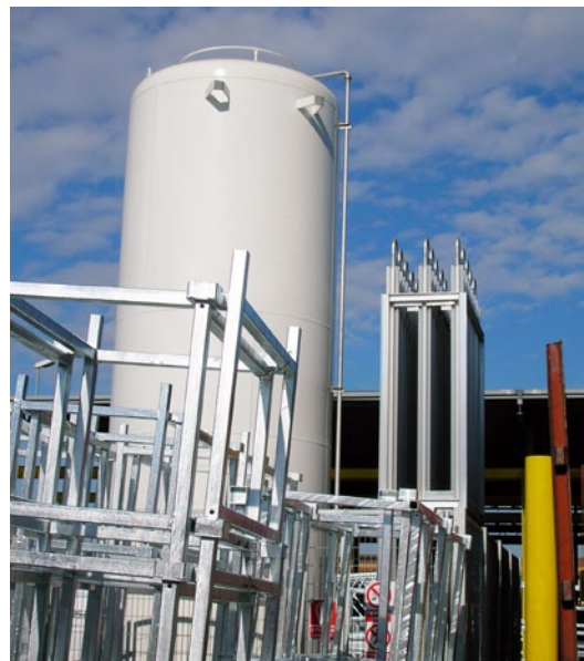
Depósito de Gas Natural
