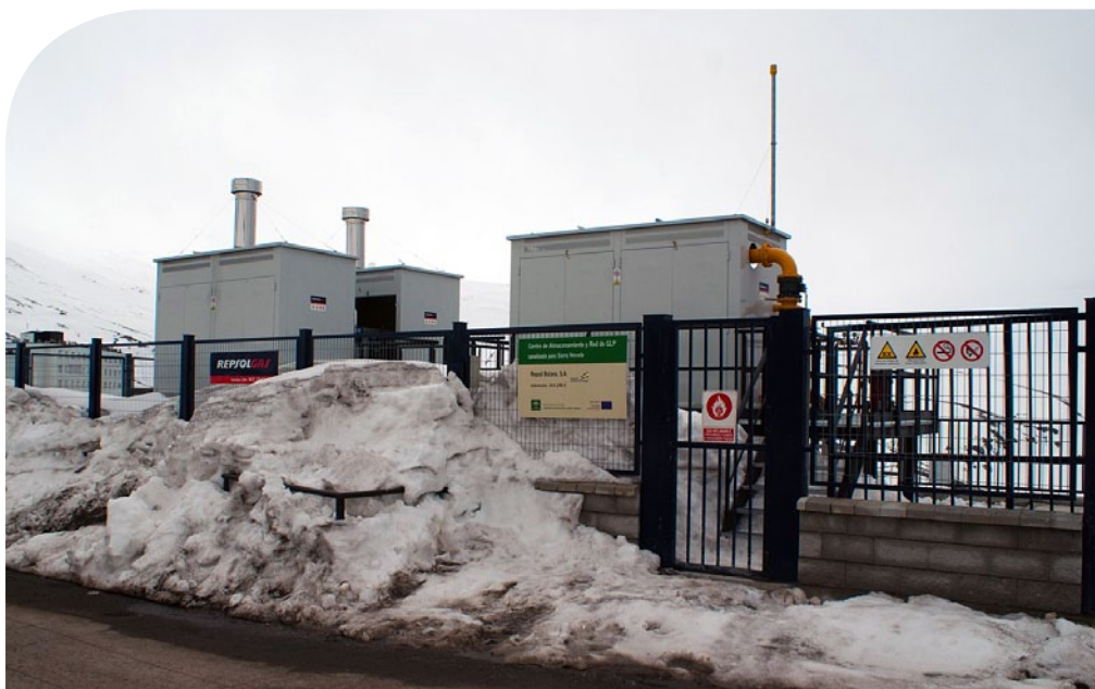
Centro de almacenamiento de GLP en Monachil (Granada).
