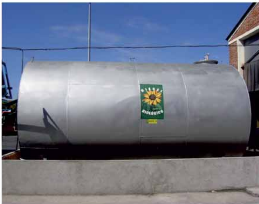
Tanque de biodiésel
